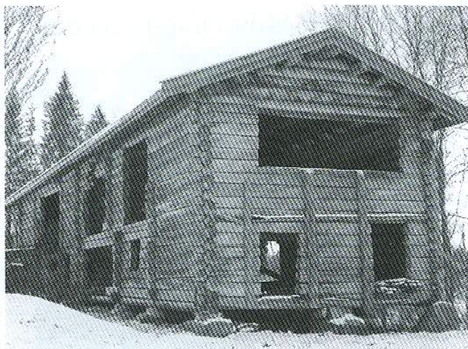
Låven mangler en god del på å være ferdig restaurert.
